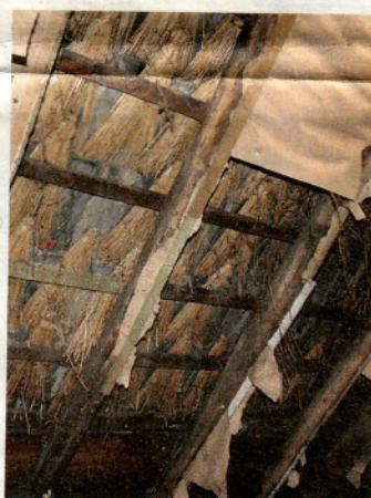
So sieht das Dach zurzeit aus. Hier muss dringend etwas getan werden.
